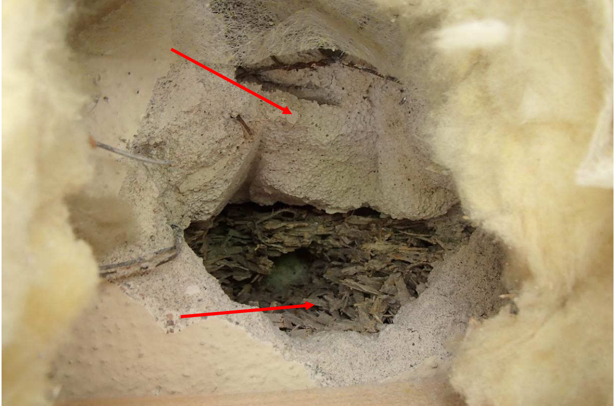
Kuva 12. Alkuperäisen ulkoseinän ja ulokkeen rajapinnassa havaittiin lastuvillaeristys (Toja) sekä kevytbetonieristys (Siporex) ulkoseinillä.
