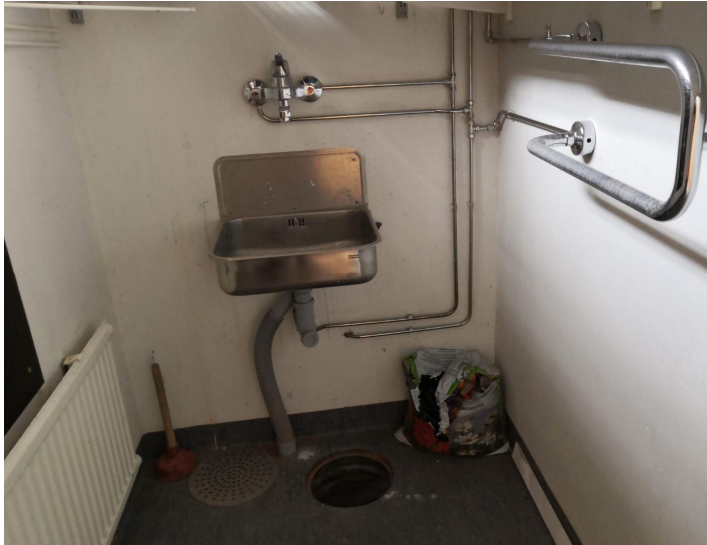
Kuva 4. Yleisnäkömä siivouskokeron varustelusta.
