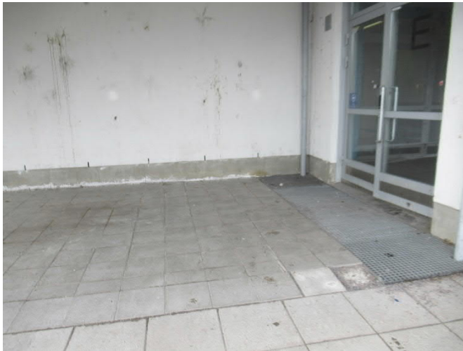
Kuva 3.4.4: Tarkastelujaksolla on perusteltua varautua ulko-ovien kunnostuksiin ja pintakäsittelyihin.
