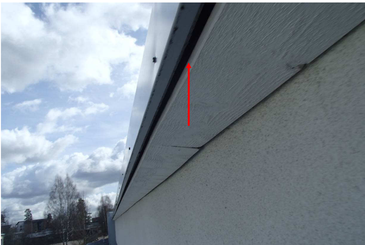
Kuva 47. Räystäiden alapuolella ei havaittu hyönteisverkkoja.
