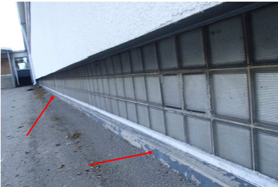
Kuva 32. Rakennuksen pohjoissivun sokkelit/maanpaineseinät ovat matalia.
