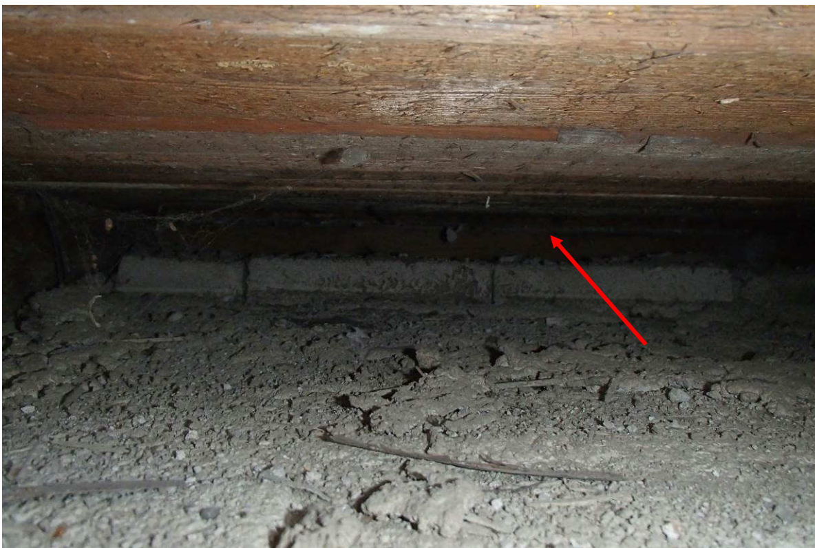
Kuva 58. Tuulettuvassa tilassa havaittiin kattovasojen välissä pitkittäin puumateriaali joka estää osittain yläpohjan tuulettumisen.
