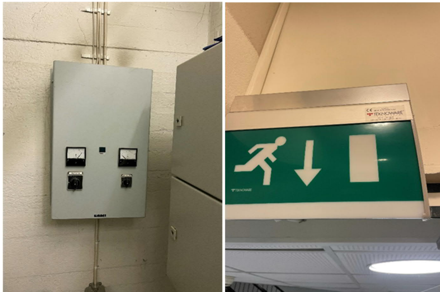
Kuvat 5.4.1-5.4.2: Turvavalokeskus ja poistumistievalaisin.
