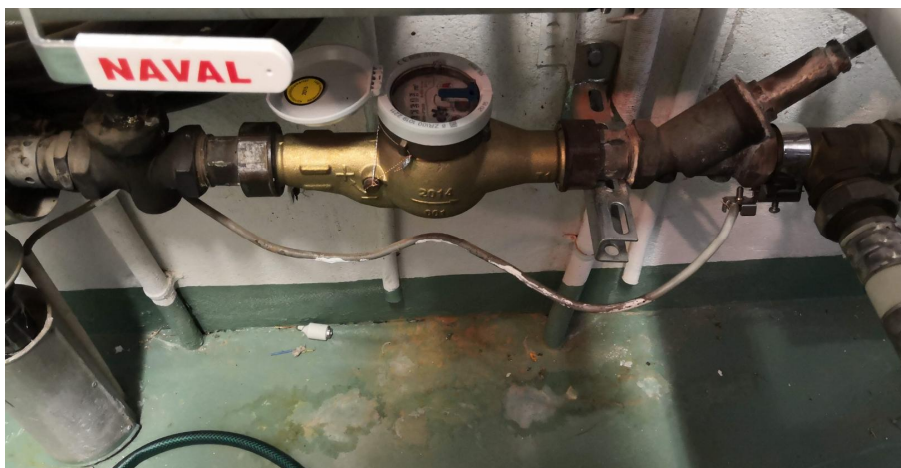
Kuva 2. Päävesimittari Aunelan puolella
