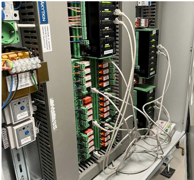
Kuva 4.5.1. Kuva A-osan 2016 peruskorjatun ilmanvaihtokonehuoneen alajakokeskuksesta
