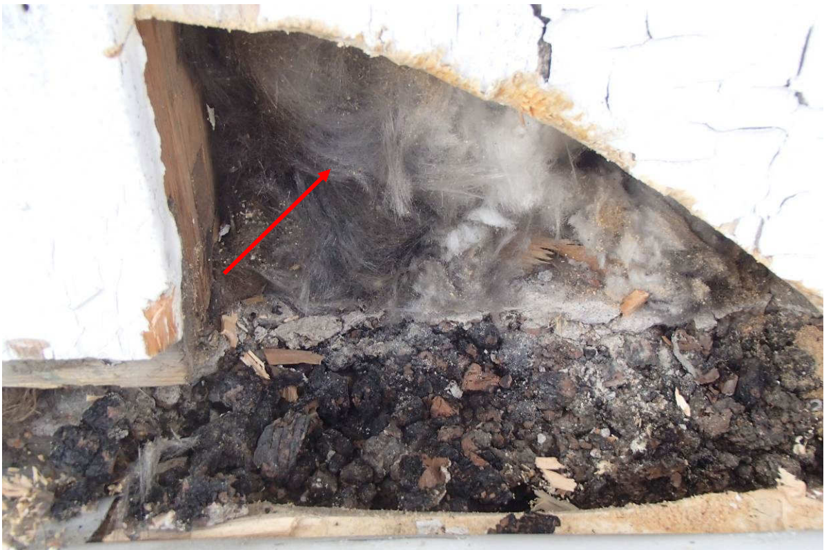
Kuva 21. Luokkien välisen seinärakenteen eristeessä havaittiin tummentumia.
