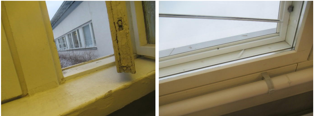
Kuvat 3.4.3-3.4.4: Uusimaton puuikkuna, jossa maalipinnan halkeilua ja hilseilyä. Puualumiini-ikkunan tiivistepuutteita.
