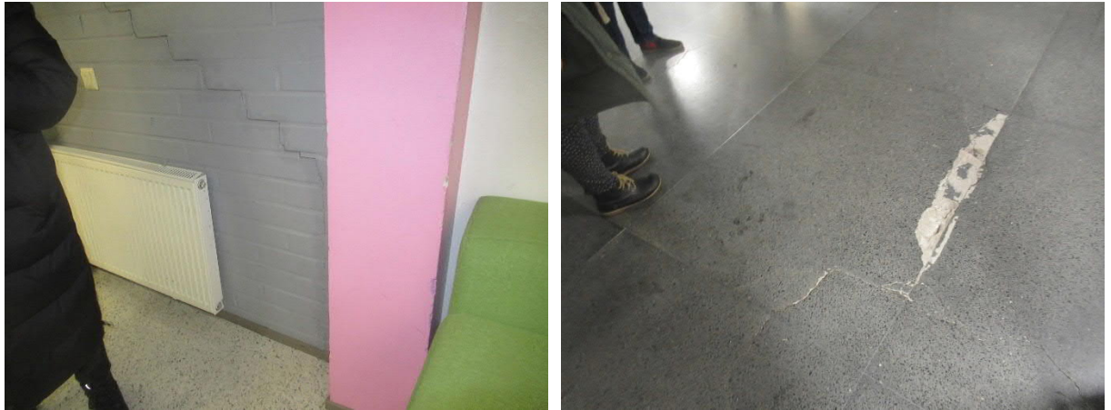
Kuvat 3.2.1-3.2.2: Paikallisia halkeamia pohjoisemmalla rakennusosalla (B-osa). Paikalliset halkeamat on syytä tiivistää/paikata ja halkeamien käyttäytymistä säännöllisesti seurata.
