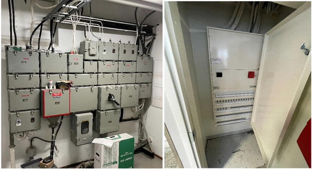
Kuvat 5.2.1-5.2.2: Vanha nousukeskus ja uusittu ryhmäkeskus.
