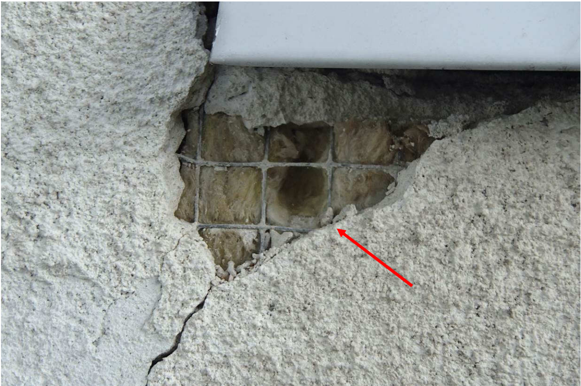
Kuva 29. Paikoin vaurioalueen lämpörappauksen rappaustaastit ovat irtoilleet.
