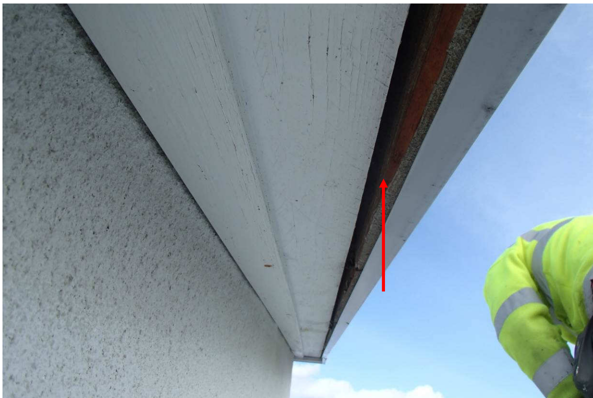
Kuva 48. Räystäiden alapuolella ei havaittu hyönteisverkkoja.
