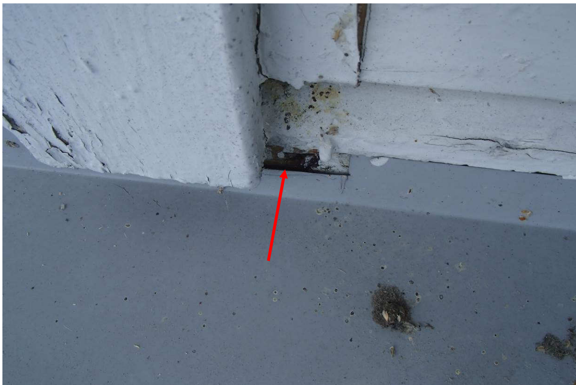
Kuva 26. Vesipellityksen ja ikkunarakenteen välissä havaittiin rakoja rakenteiden sisään.
