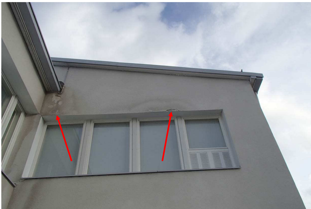
Kuva 27. Sadevesi on kulkeutunut julkisivujen lämpörappauksen sisään vaurioittaen lämpörappausa.
