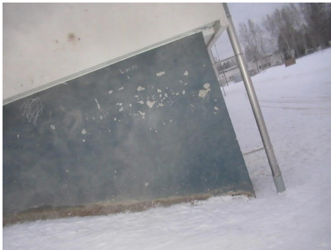
Kuva 3.2.3: Perusmuurin maalipinnan hilseilyä. Puhdistus ja ylimaalaus aiheellista.
