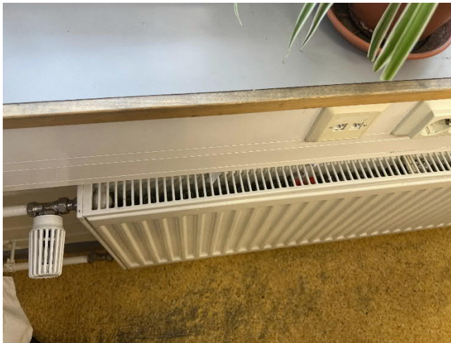
Kuva 4.1.1: Luokkahuoneen lämmityspatteri ja termostaattiventtiili
