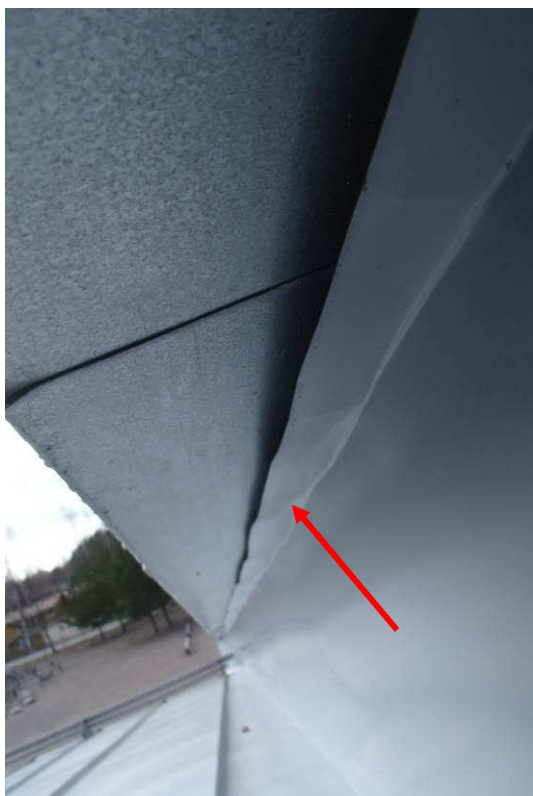
Kuva 49. Vesikaton vastataitokset ovat paikoin puutteellisia.
