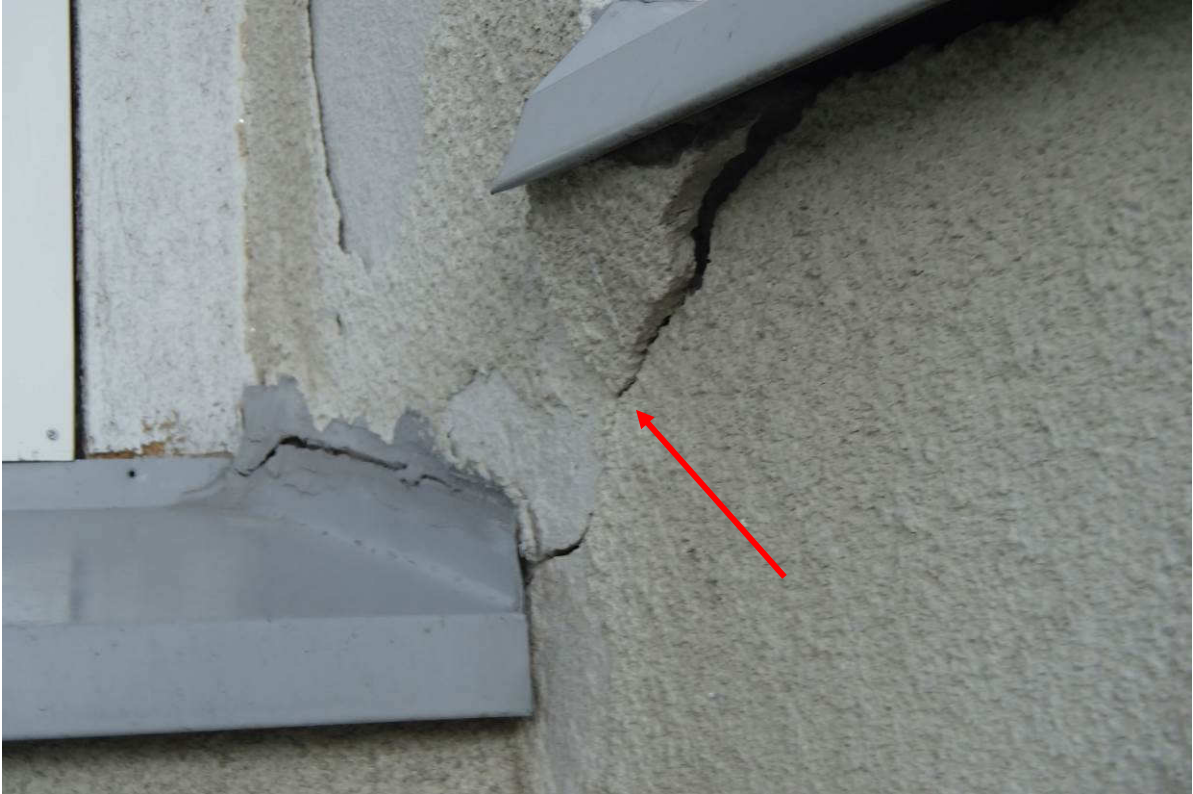
Kuva 28. Vaurioituneessa lämpörappauksessa havaittiin halkeilua.
